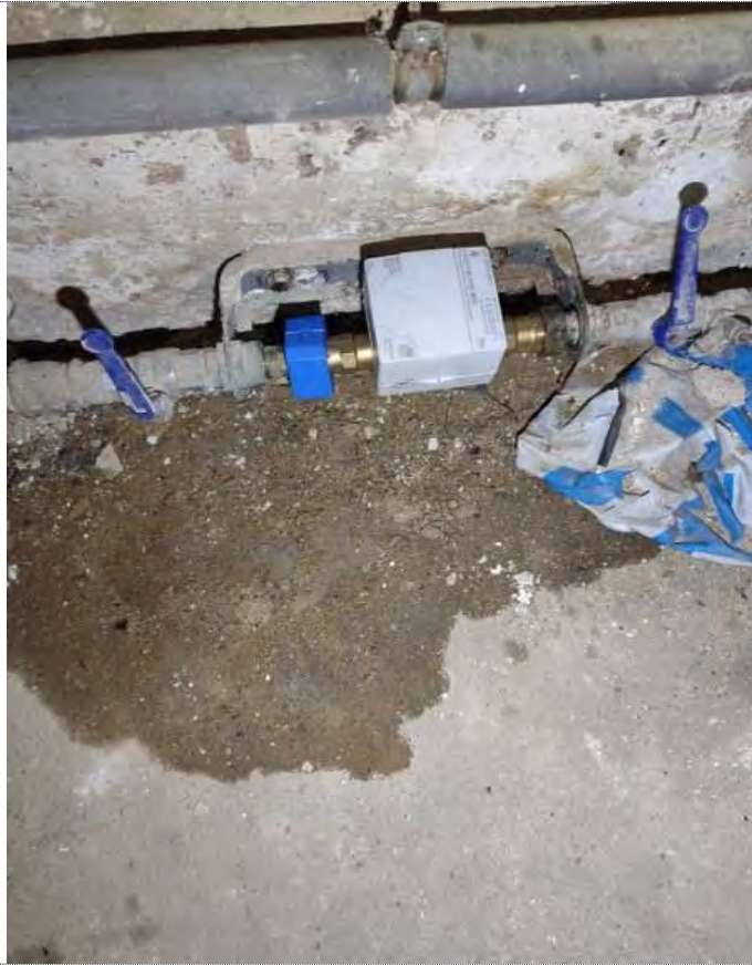
Blick auf den neuen Wasserzähler
