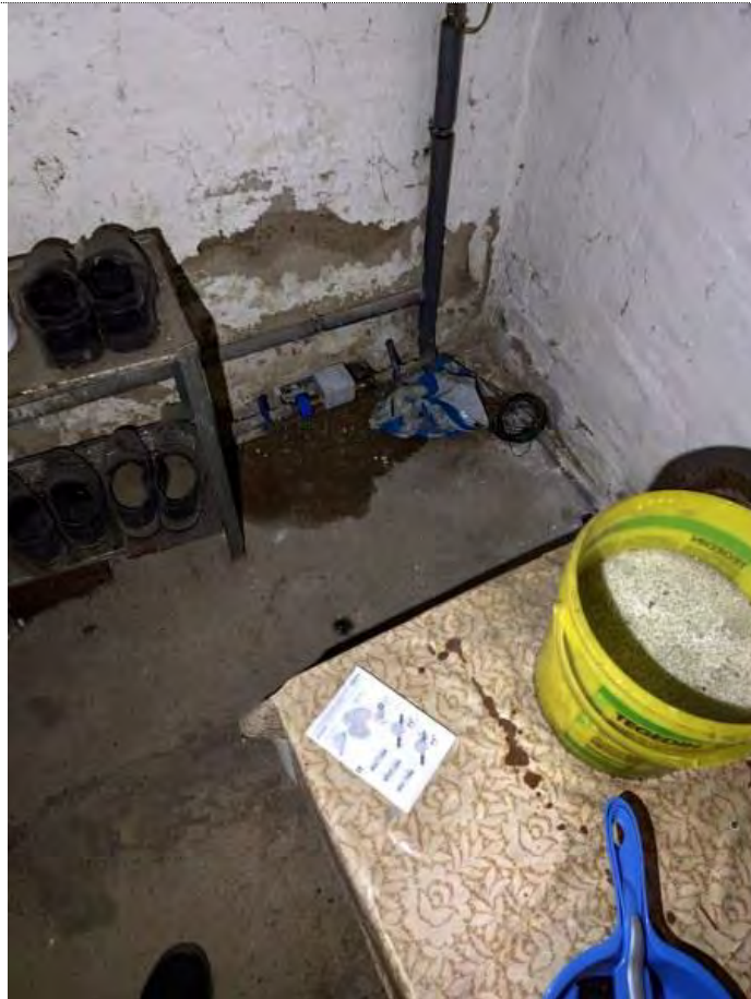
Wasserzähler in der hinteren Ecke links, wenn man den Kellerraum betritt
