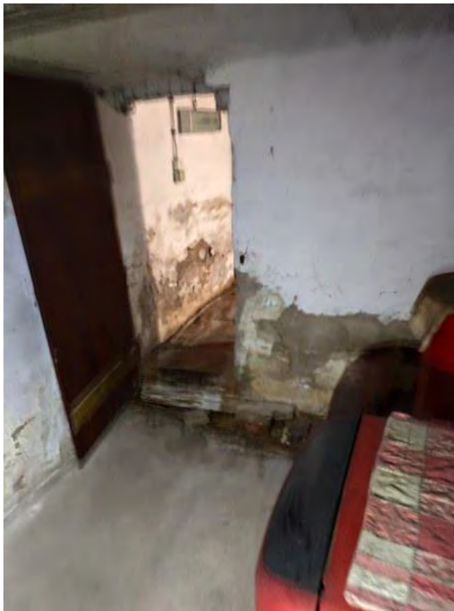
Blick von der Heizung aus zum dritten Kellerraum in Richtung Nordost
