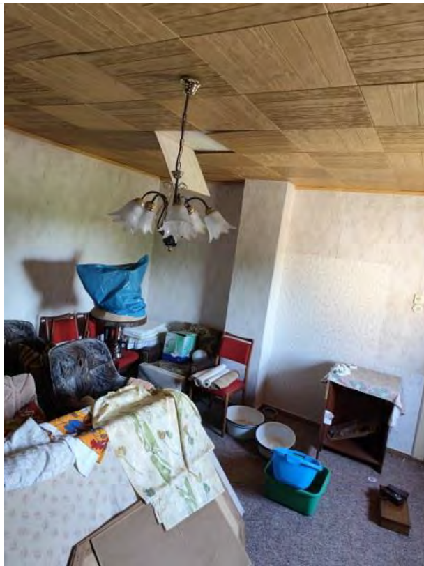
Wohnzimmer mit lockerem Deckenpaneel
