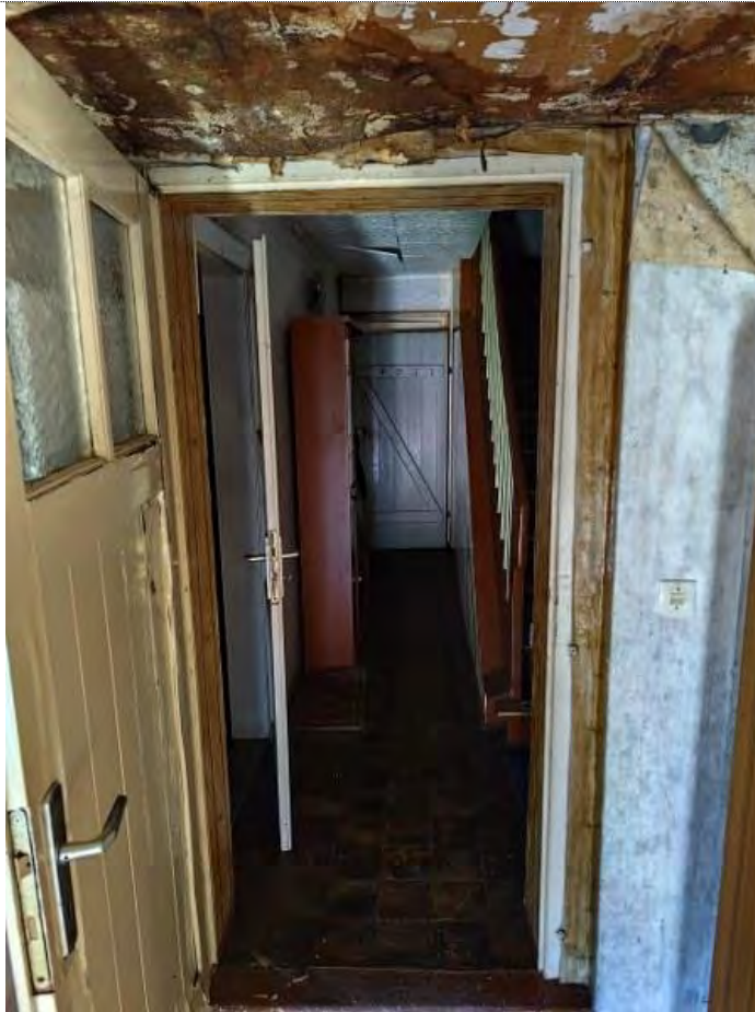
Wasserschaden und Schimmel im Vorraum über der Tür, die in den Flur führt, mit Blickrichtung Nordost
