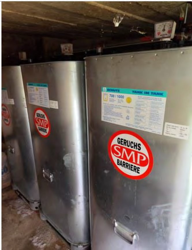
Blick auf die 3 Öltanks
