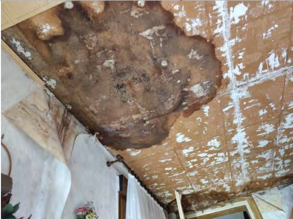
Wasserschaden und Schimmel im Vorraum - links von der Haustür aus gesehen
