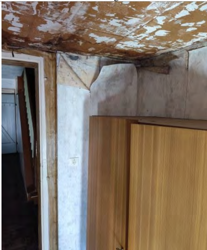
Wasserschaden und Schimmel rechts über der Tür im Vorraum, die in den Flur führt
