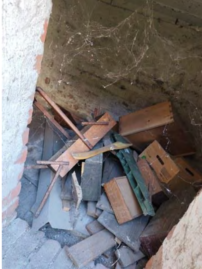
Holzablagerungen in der Kammer
