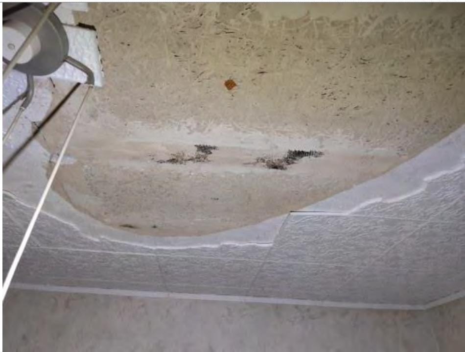
Deckenschaden im Wohnzimmer
