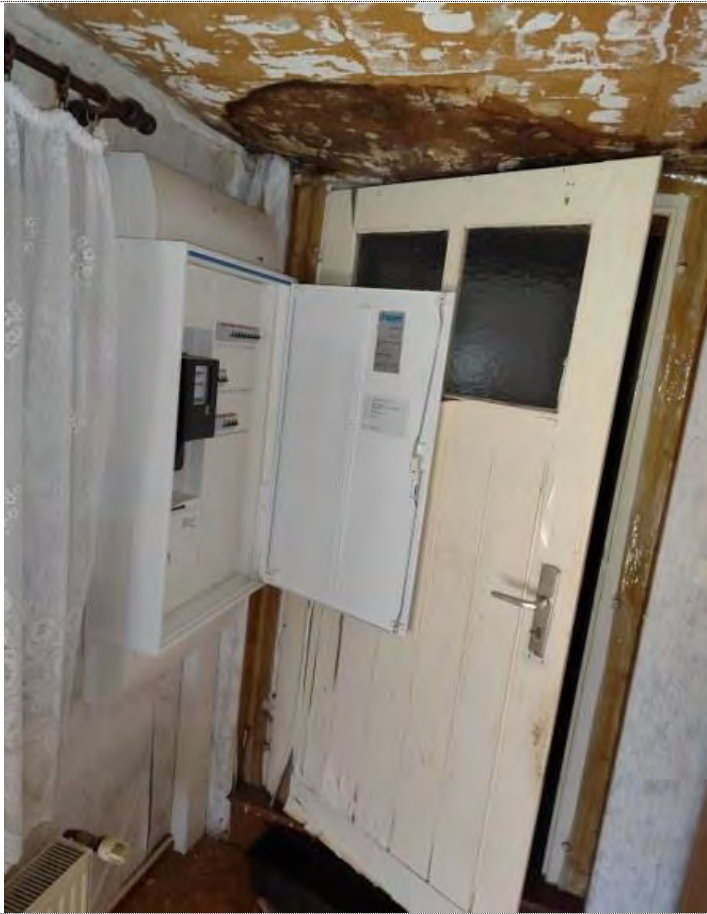
Stromkasten im Vorraum, dahinter ist die Tür zum Flur, mit Blick in Richtung Nordost
