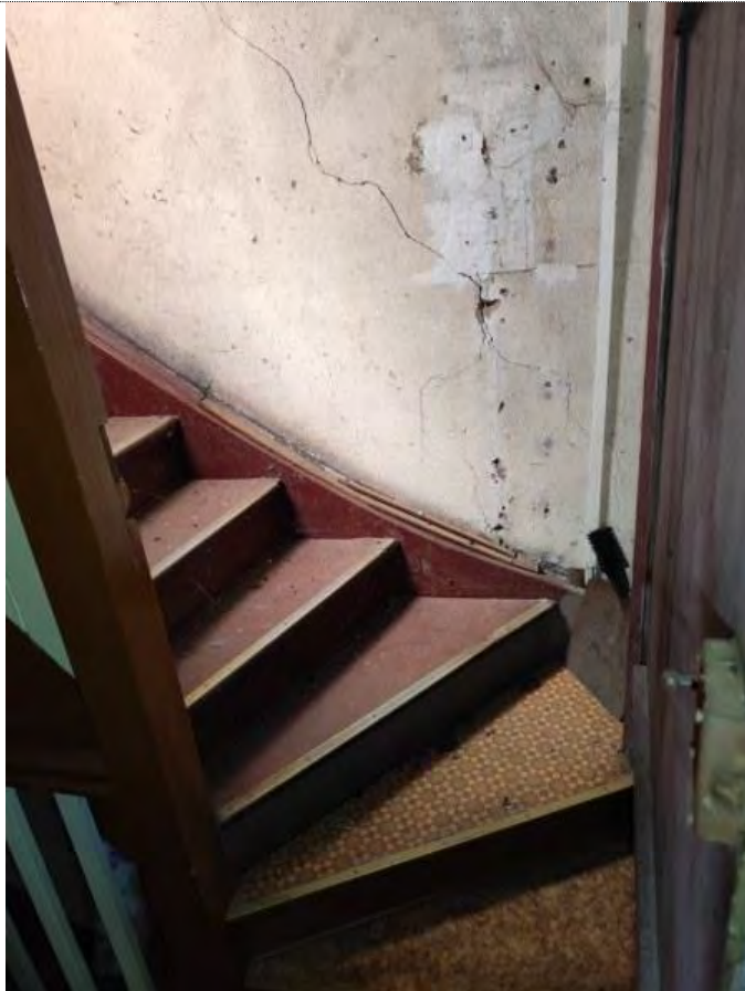
Rissbildungen im Bereich der Treppe zum Dachboden
