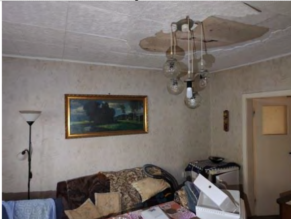
Wohnzimmeransicht mit deutlich sichtbaren Schäden an der Decke
