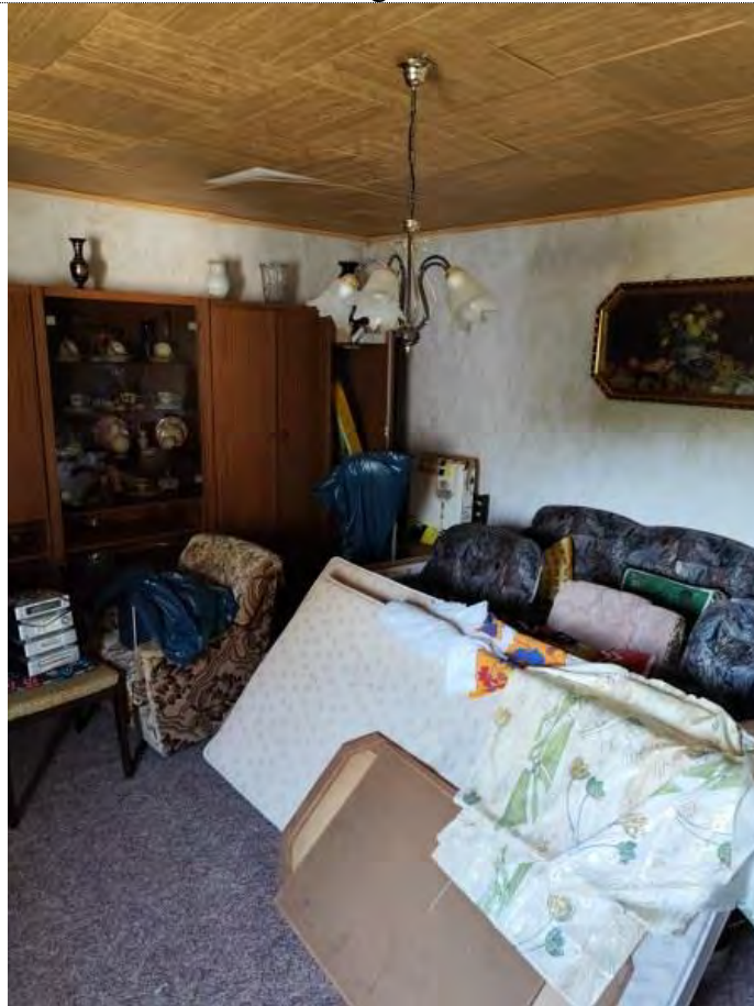
Blick ins Wohnzimmer in Richtung Norden; oben an der Decke ist ein lockeres Paneel
