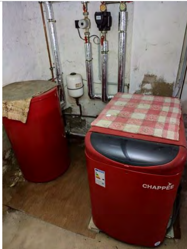
Heizung im ersten Kellerraum in Blickrichtung Süden; rechts geht es zur Kellertreppe, hinter dem Fotostandpunkt in den mittigen Kellerraum und links geht es in den dritten Raum des Kellers
