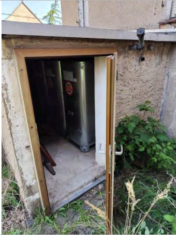
Blick vom Innenhof in den Schuppen mit den Öltanks für die Heizung
